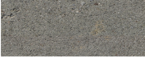
Balkon ohne Abdichtungsbahn
